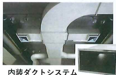
内装ダクトシステム
